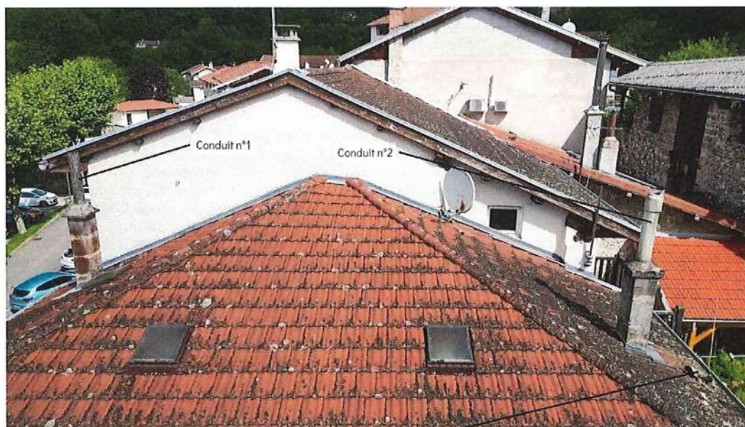
Débris en fibres ciment
