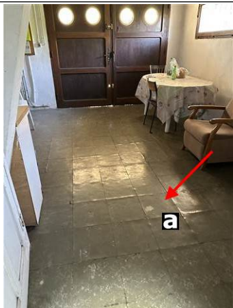
Photo n° PhA005 Localisation : Garage Ouvrage : 5 - Planchers et planchers techniques - Revêtements de sols Partie d'ouvrage : Dalle de sol Description : Dalle de sol Localisation sur croquis : M005
