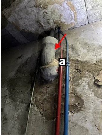
Photo n° PhA002 Localisation : Cave 4 Ouvrage : 6 - Conduits et accessoires intérieurs - Conduits de fluides (air, eau, vapeur, fumée, échappement, autres fluides) Partie d'ouvrage : Conduit en fibres-ciment Description : Conduit en fibres-ciment Localisation sur croquis : M002
