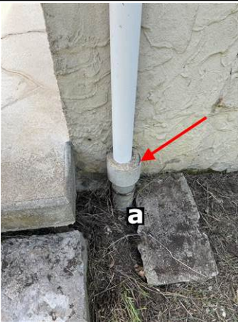
Photo n° PhA007 Localisation : Facade Ouvrage : 6 - Conduits et accessoires intérieurs - Conduits de fluides (air, eau, vapeur, fumée, échappement, autres fluides) Partie d'ouvrage : Conduit en fibres-ciment Description : Conduit en fibres-ciment Localisation sur croquis : M007
