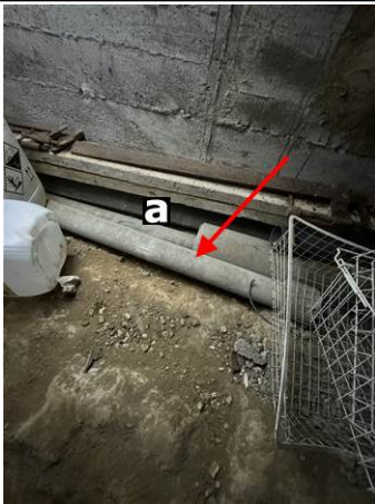
Photo n° PhA003 Localisation : Vide sanitaire Ouvrage : 6 - Conduits et accessoires intérieurs - Conduits de fluides (air, eau, vapeur, fumée, échappement, autres fluides) Partie d'ouvrage : Conduit en fibres-ciment Description : Conduit en fibres-ciment Localisation sur croquis : M003
