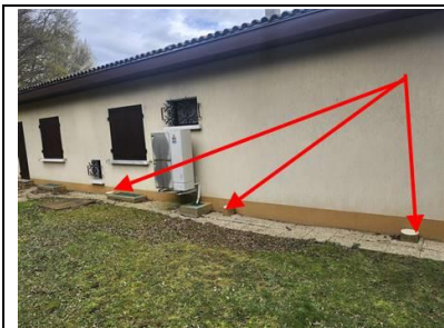
PHOTO N° PHA001 LOCALISATION : REZ DE JARDIN - EXTÉRIEUR OUVRAGE : CONDUITS DE FLUIDES (AIR, EAU, AUTRES FLUIDES) PARTIE D'OUVRAGE : CONDUITS DESCRIPTION : CONDUITS LOCALISATION SUR CROQUIS : M001
